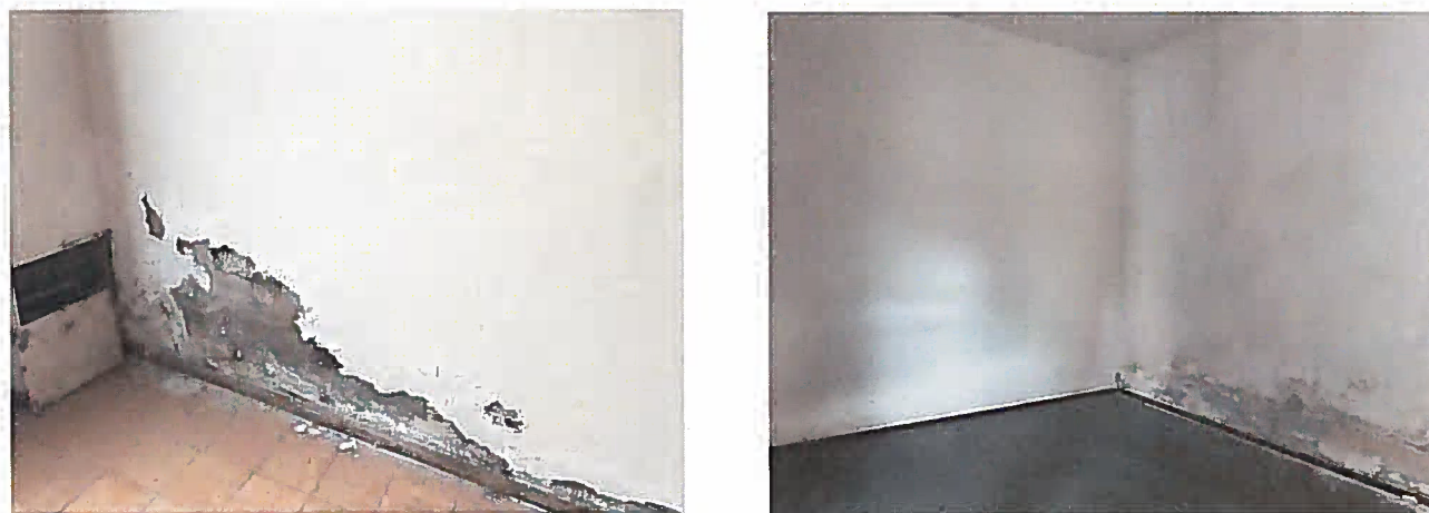
Fig. 5.4 – Immagini di degrado e distacco dell'intonaco causato da umidità da risalita.
